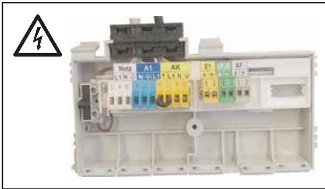
Bild: Klemmkasten, Gefahr durch elektrische Spannung
